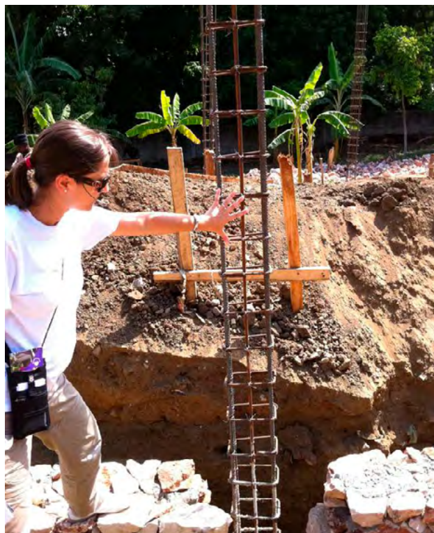
Evaluación de una vivienda en construcción en Cabo Haitiano, Haití, en 2011. Trabajo de cooperación para determinar la vulnerabilidad y el riesgo sísmico en las ciudades del norte de Haití, donde existe alta probabilidad de ocurrencia de sismos.
